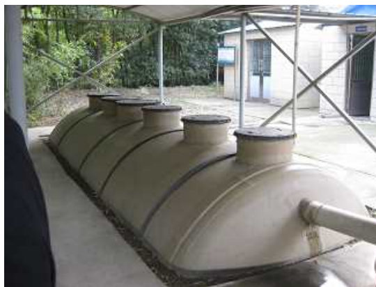
「江蘇省無錫市惠山区鉄路橋村高度処理型合併浄化槽設置計画」（平成 21 年度草の根無償資金協力）で設置した高度処理型合併浄化槽
